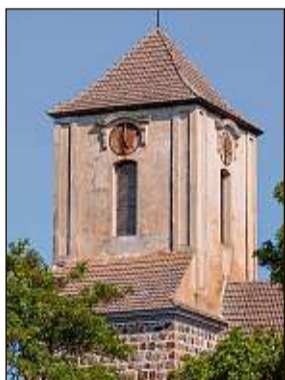
Stehen gebliebene Zeit: Der Kerkower Kirchturm mit der Turmuhr soll saniert werden.
